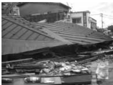
図1 ▶ 2004年新潟県中越地震での家屋倒壊
