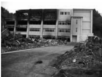
図5 ▶ 2011年東日本大震災での津波後の建物火災
